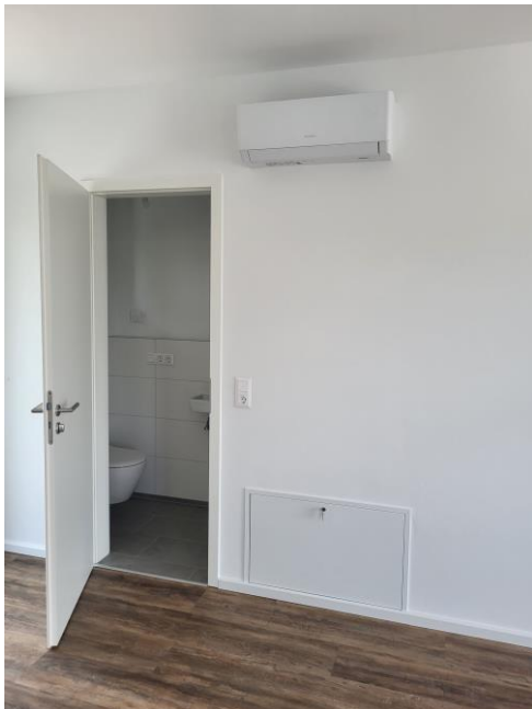
Klimaanlage im Dachgeschoss
